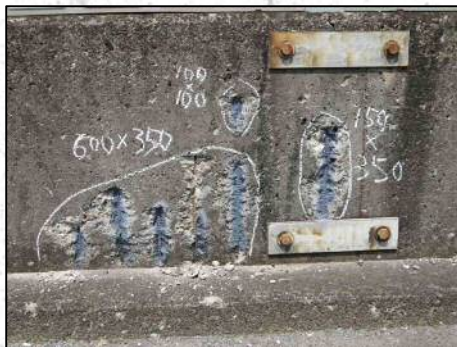
壁高欄や地覆の剥離、鉄筋露出
