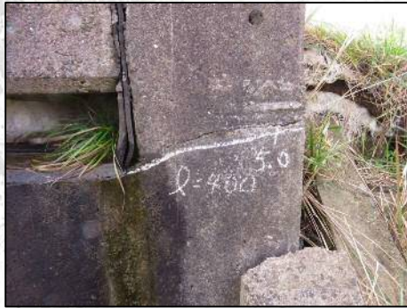
下部工のひびわれ、欠損、剥離、 鉄筋露出
