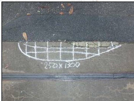
伸縮装置後打材の欠損
