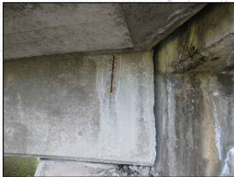
主桁の剥離、鉄筋露出
