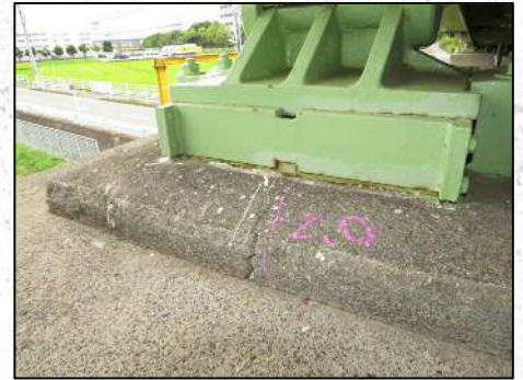
支承沓座モルタルのひびわれ、 欠損
