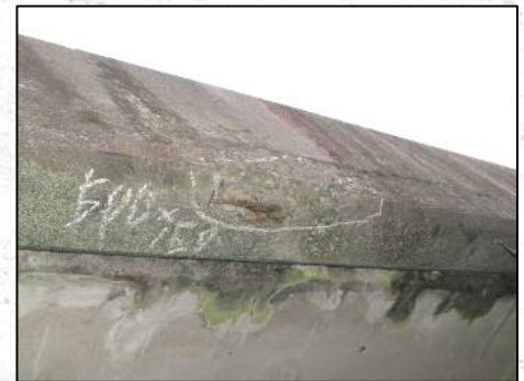
床版張出部、地覆水切り部の剥離、 鉄筋露出
