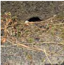
柵の土砂詰まり
