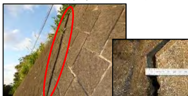
目地部の段差・ひびわれ
